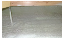
発泡ウレタン断熱材を屋根・壁には16cm、床下(基礎)部分には8cmも吹き付けています。外気を徹底的に遮断しています。
