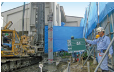
湯浅建設さんによる実際の杭工事の様子 杭にメモリがあり、地盤調査で得られた情報が正確であるか実際に確認している。
